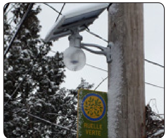
Figure 26 : Éclairage solaire. Crédit : REQ.
